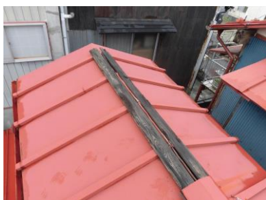
風災での屋根の破損
