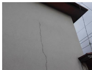
地震でのひび割れ
