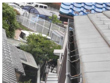
雪災での雨樋の破損
